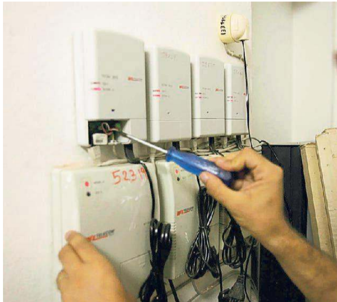
Un tecnico della Tim al lavoro per riparare un guasto (Foto Silvi)
